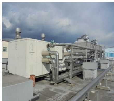
ガス炊吸収式冷温水発生機
