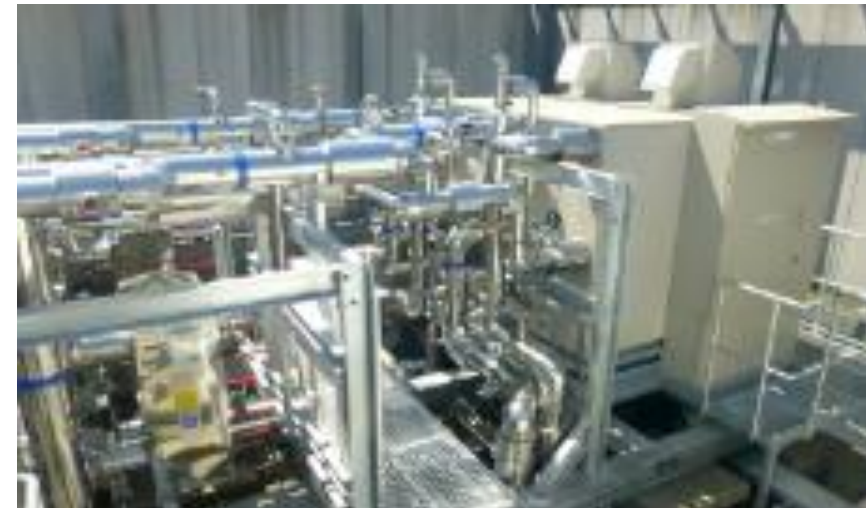
地中熱ヒートポンプ
