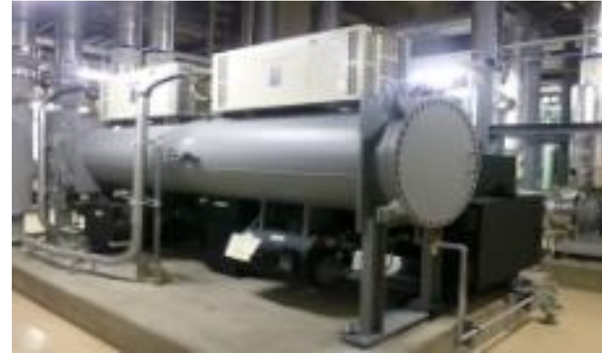
ターボ冷凍機
