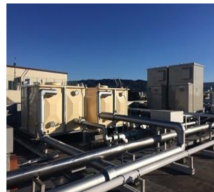
井戸水熱源HP冷温水発生機
