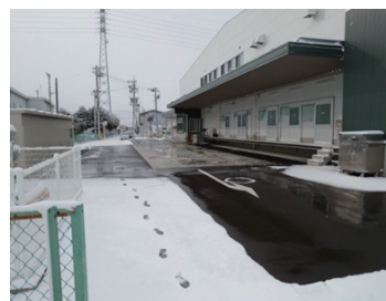
未利用熱利用融雪システムにより雪がとけた状態です
