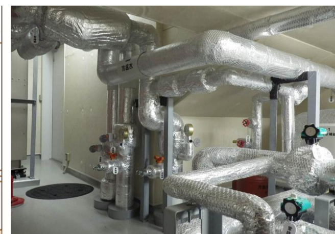
ヒートポンプと補機は階段下の機械室に設置されている。
