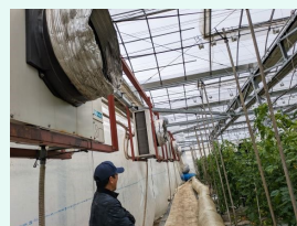
ヒートポンプファンの設置状況
