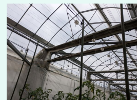
カーテン設備
