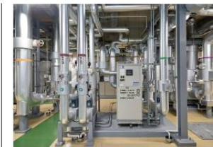
導入された地中熱ヒートポンプ
