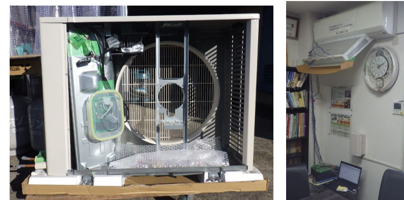
室外機と室内機/計測装置
