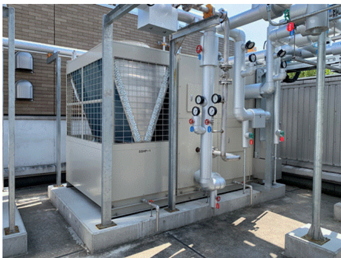
天空熱源ヒートポンプ実証装置 (実証場所：(株)豊田自動織機大府工場)
