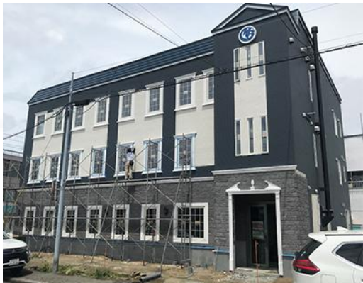
ZEB仕様実証建物（地中熱ヒートポンプシステム、高断熱仕様外皮、放射空調システム、太陽光発電）
