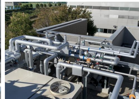
熱源水ループ配管
