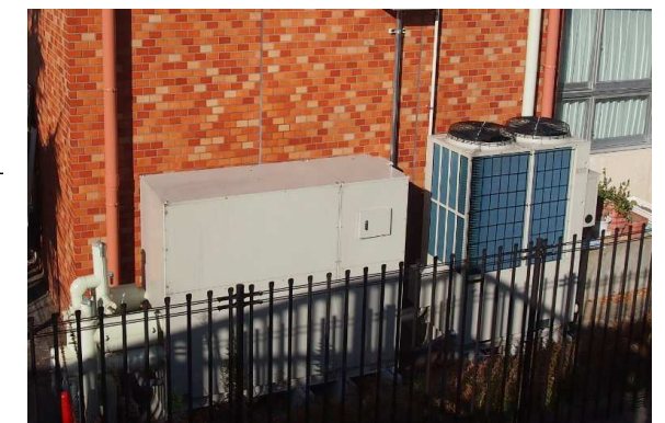
[熱源機器] 左) 地下水熱交換ユニット。井水-不凍液間の熱交換器や各種制御装置が収納されている。右) 空水冷ビル用マルチエアコン
