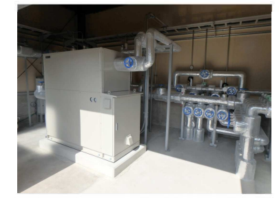
[機器室内の専用ヒートポンプと揚水注入ヘッダー配管]
