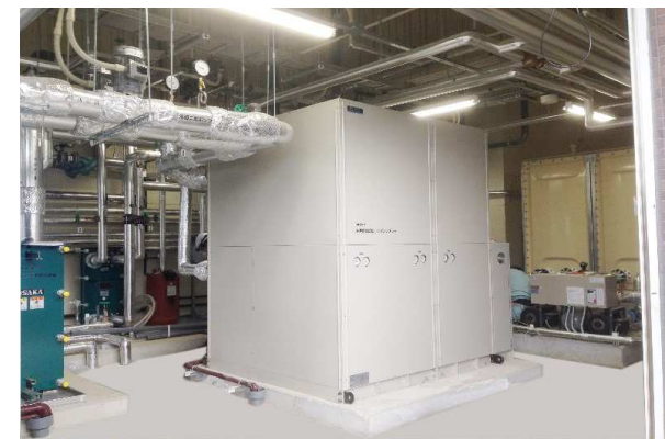
[井水熱対応ヒートポンプチラー]
