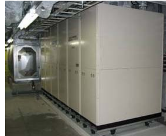
高温型ヒートポンプ(R407D)
