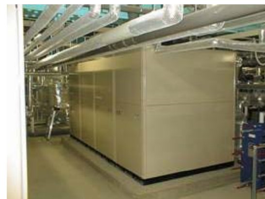
ヒートポンプ
