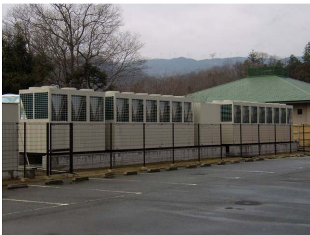
ヒートポンプ
